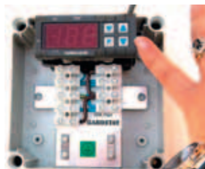
Данный корпус ENSTO CUBO S используется в системе контроля температур.
